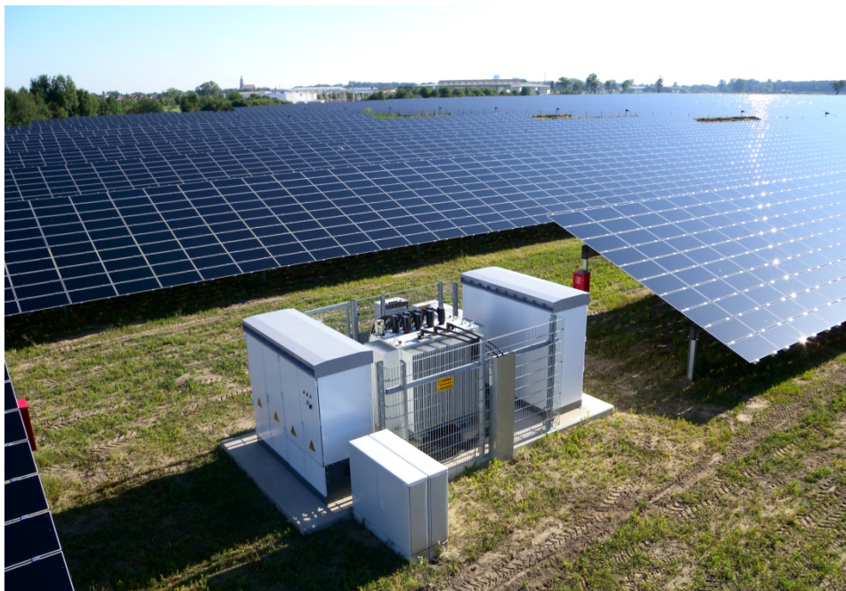
Bildunterschrift: Wechselrichterstation in einem netzstabilisierenden Freiflächen- Solarkraftwerk.
